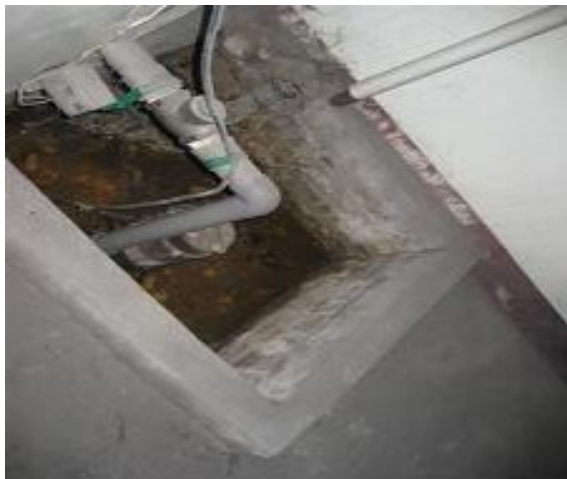
地下室儲水槽
