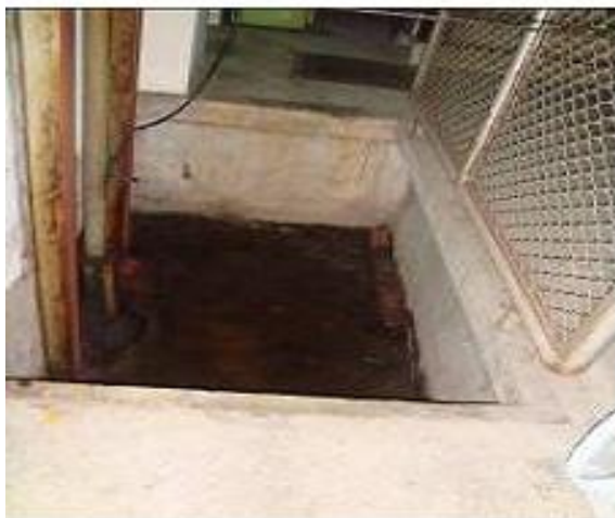
地下室之升降梯孔積水
