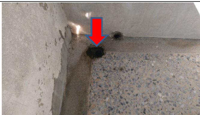
走廊排水孔阻塞積水
