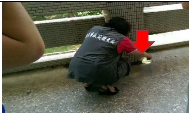
走廊排水溝積水
