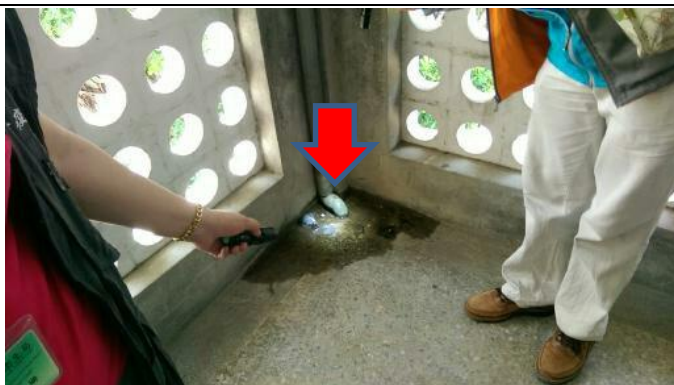
走廊排水孔處積水
