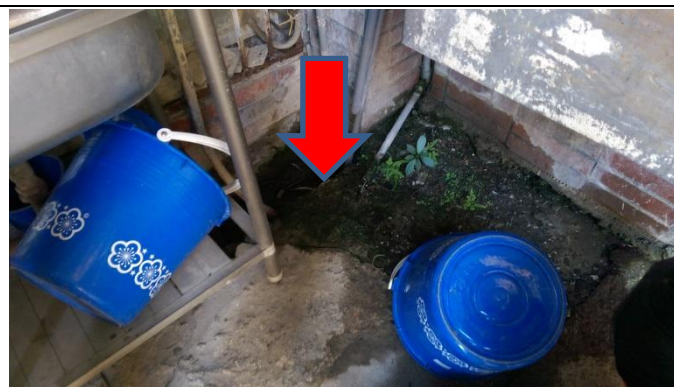
校園角落陰暗處水溝阻塞積水
