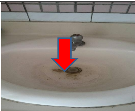
故障洗手台積水
