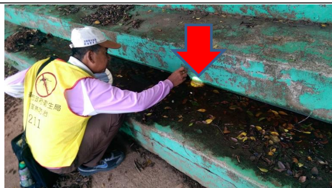
圍牆旁階梯下雨過後積水
