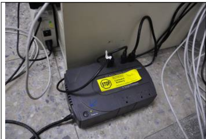
五、設置穩壓系統，維持主機穩定運作
