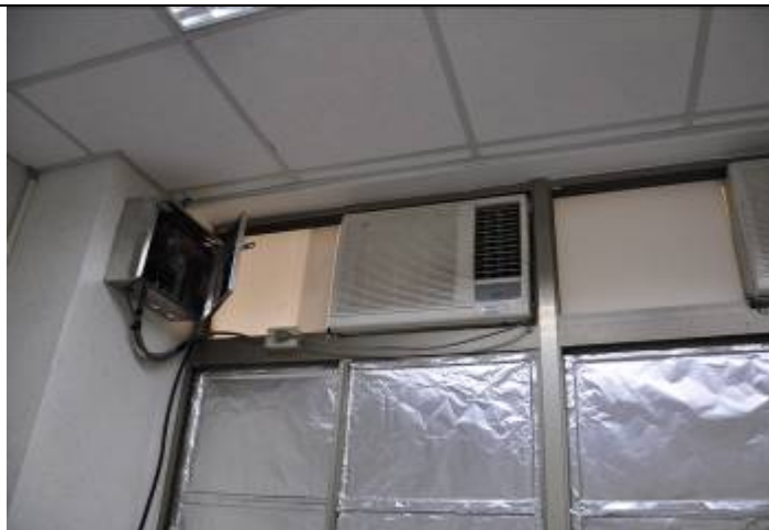
四、設有自動啟動器，兩台冷氣交替運作
