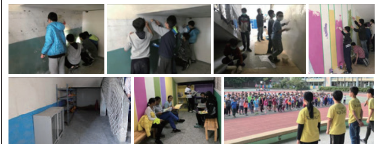
小組美力行動 < 閱讀角 >：樓梯間牆面刮除、批土、油漆、書籍上架、進行全校宣導
