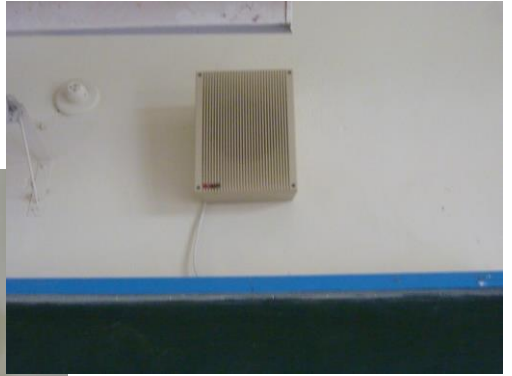
教室擴音設備
