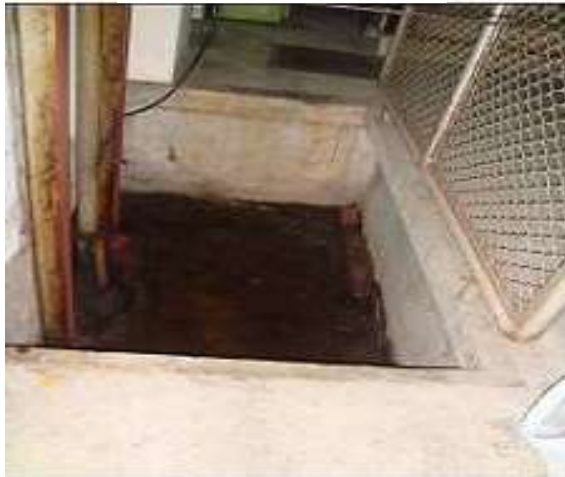
地下室之升降梯孔積水
