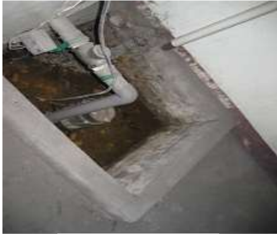
地下室儲水槽
