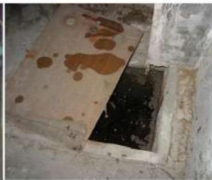
地下室汗水池
