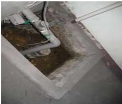
地下室儲水槽
