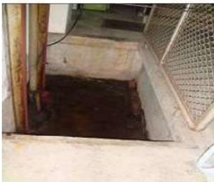
地下室之升降梯孔積水
