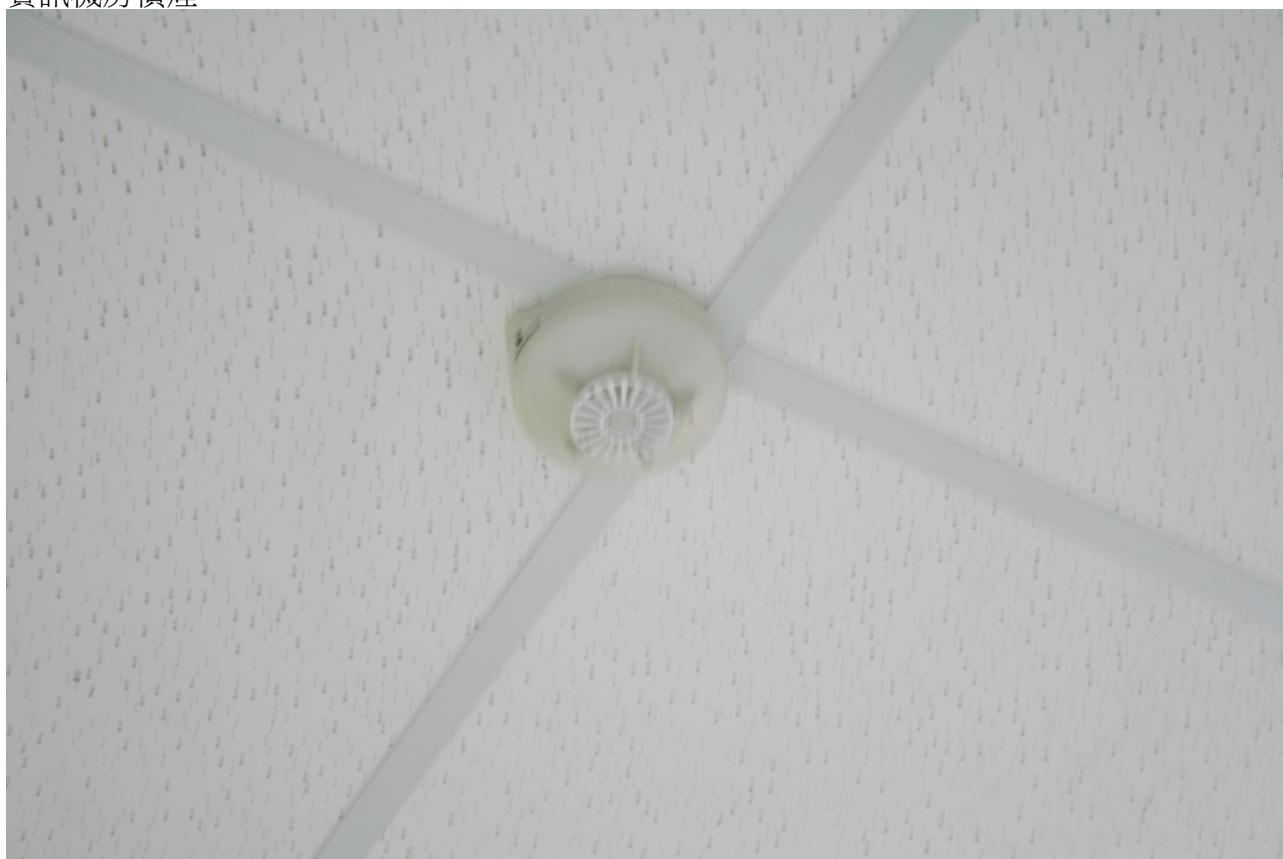
資訊機房偵煙
