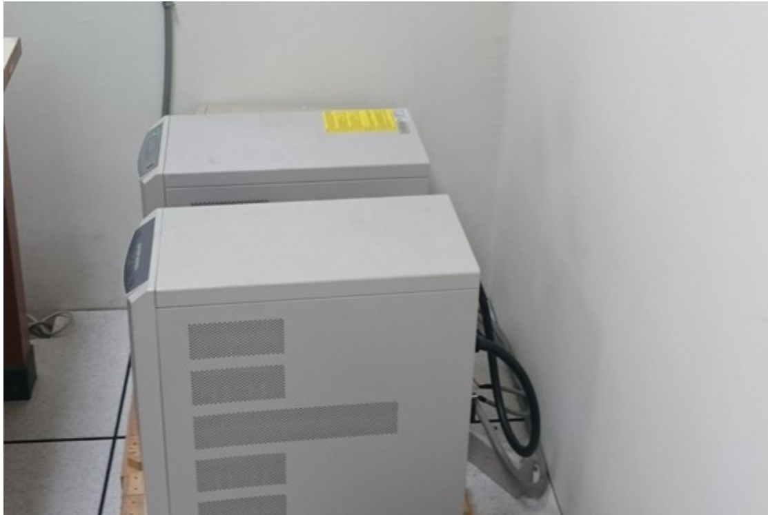
UPS 不斷電系統
