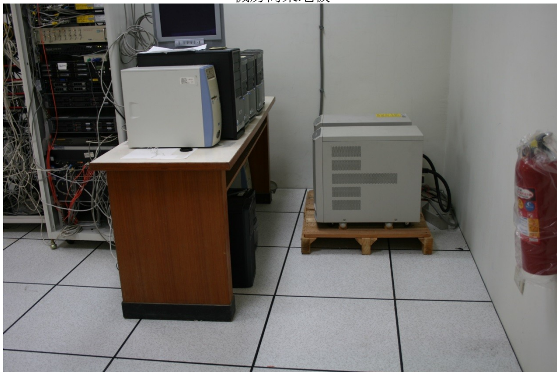
機房高架地板
