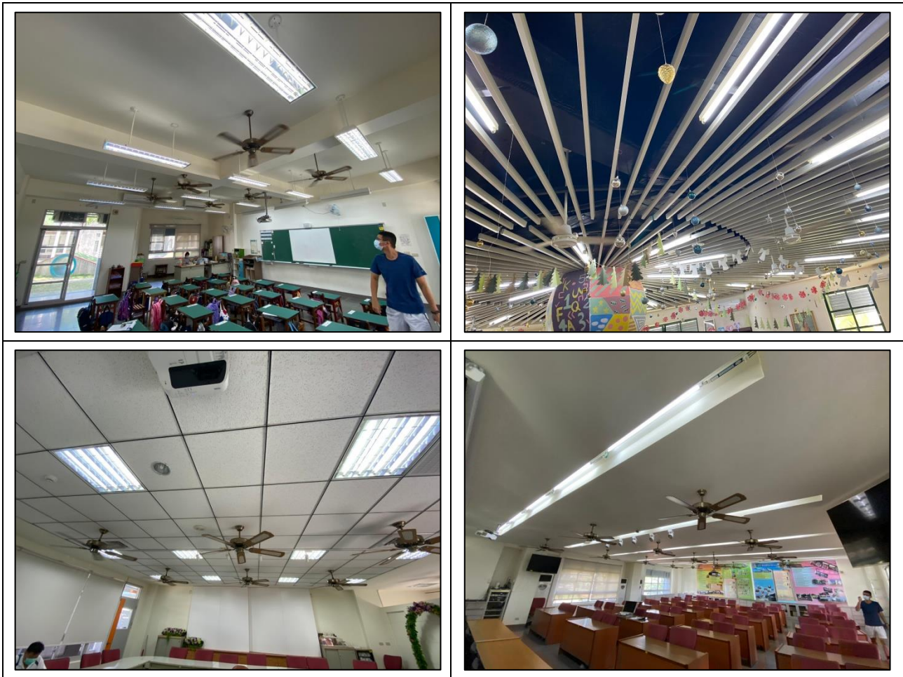
圖 3.2 照明設備現場使用現況
