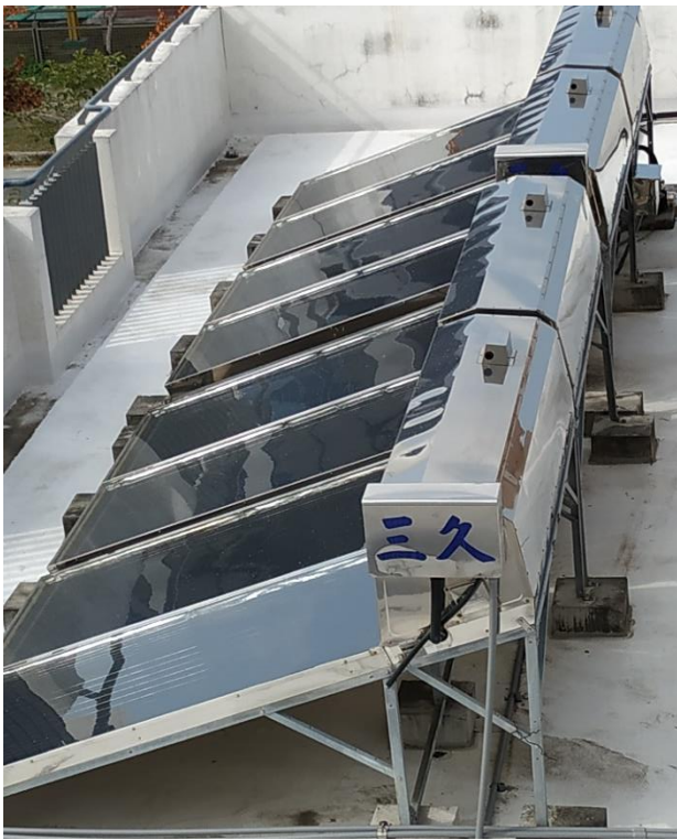
廚房屋頂設置太陽能熱水器
