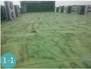
改善前-屋頂地坪防水層老舊
