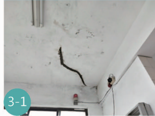
改善前-頂樓廁所天花板龜裂
