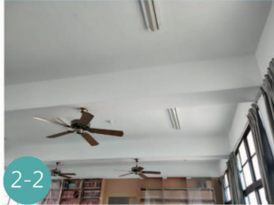
改善後-舊圖書館天花板龜裂滲水
