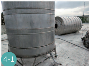
改善前-老舊水塔
