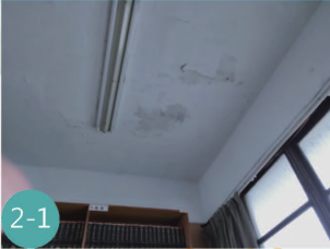
改善前-舊圖書館天花板龜裂滲水
