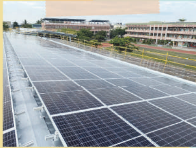
光電球場屋頂設施
