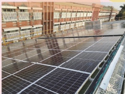
屋頂光電設施
