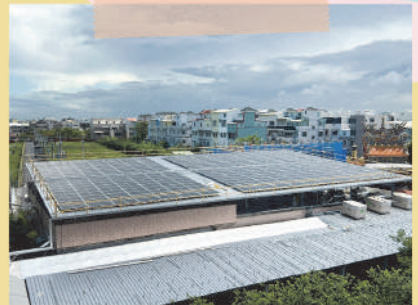
屋頂光電設施
