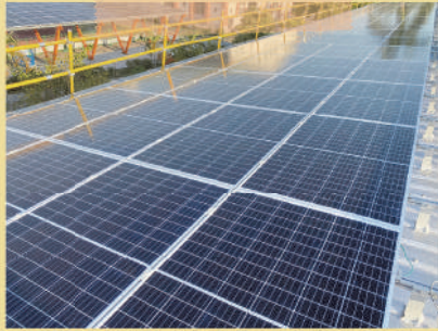
光電球場屋頂光電設施(局部)
