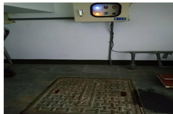
飲水機廢水回收至地下水槽供廁所使用
