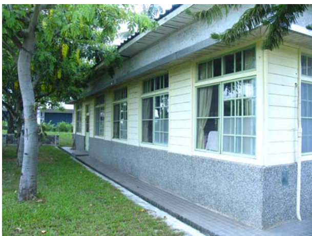
照片1-3-17 修復前辦公室木窗扇現況照片。
