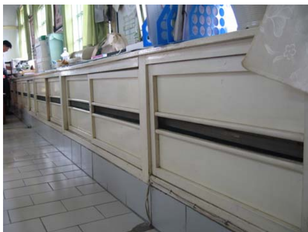
照片1-3-31 辦公室室內木櫃修復前現況照片。
