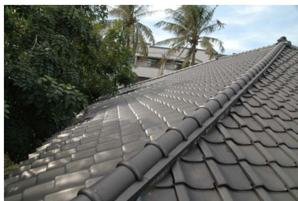
照片1-3-30 辦公室屋頂修復前現況照片 (4)。
