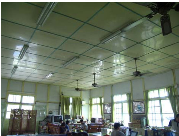
照片1-3-11 修復前辦公室室內天花現況照片（1）。
