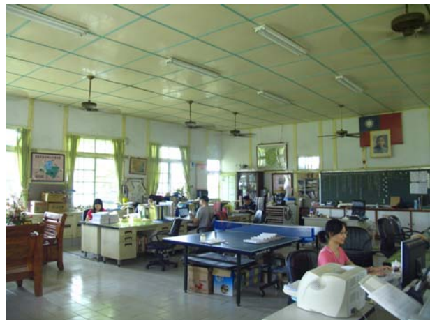
照片1-3-12 修復前辦公室室內天花現況照片（2）。
