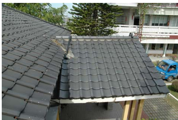
照片1-3-29 辦公室屋頂修復前現況照片 (3)。
