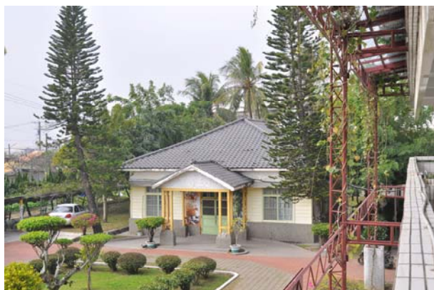
照片1-3-27 辦公室屋頂修復前現況照片 (1)。
