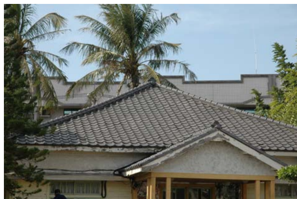
照片1-3-28 辦公室屋頂修復前現況照片 (2)。
