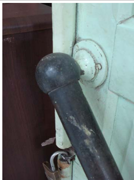
照片1-3-20 修復前辦公室 D1 木門扇五金現況照片。
