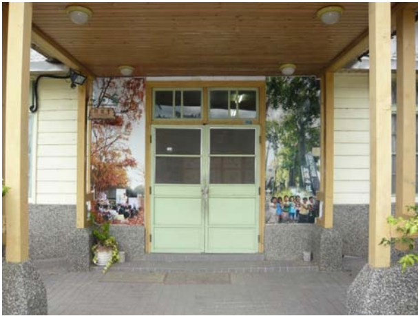
照片1-3-9 修復前辦公室主入口牆體現況照片。
