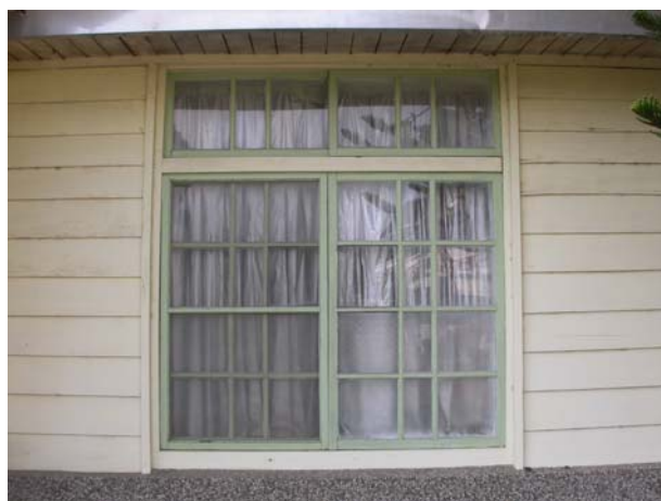
照片1-3-16 修復前辦公室 W15 木窗扇現況照片。
