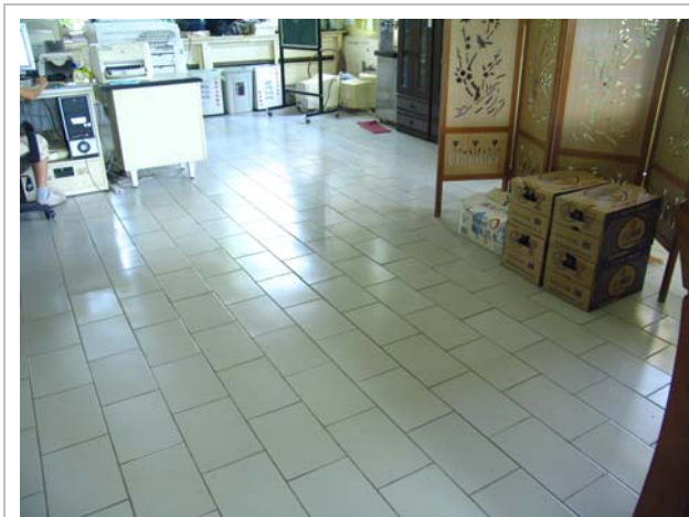
照片1-3-3辦公室修復前室內地坪現況照片。
