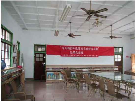
【木摺灰泥牆修復前】
