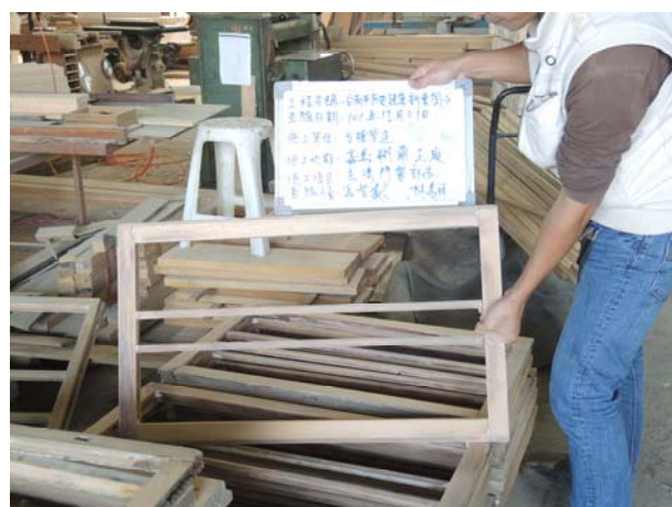
照片4-1-20 窗扇剝漆後查驗情形 (2)。
