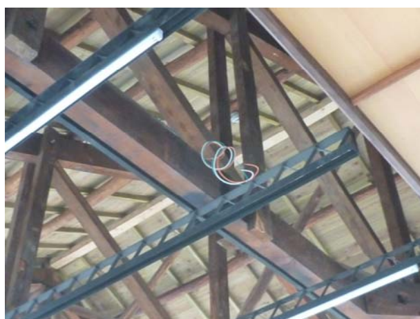
照片4-3-10 室內燈具為 T5 燈管，以鋼架做為支撐架，非直接固定於屋架上。
