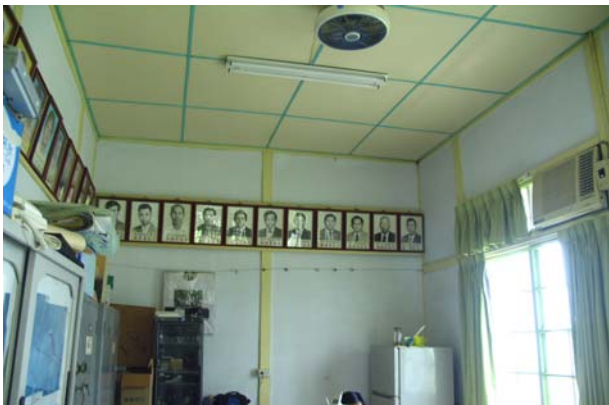
照片4-2-35 辦公室 2 天花修復前照片。
