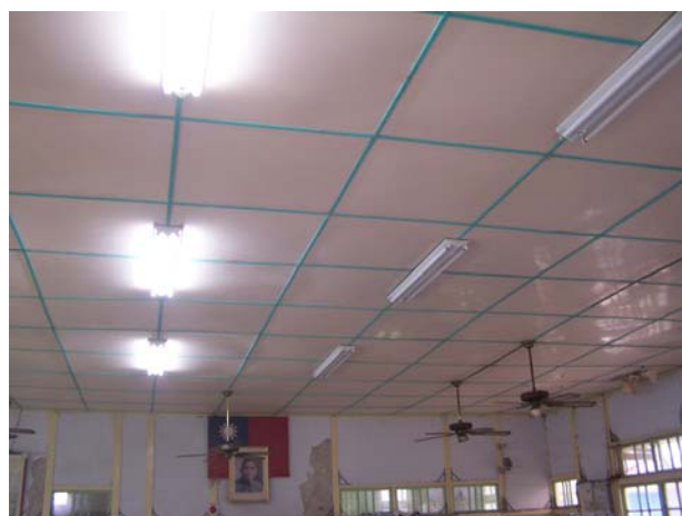
照片4-2-2 天花板為後期增設夾板天花。
