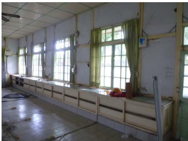
照片4-1-5 木造辦公室門窗與窗簾修復前情形。
