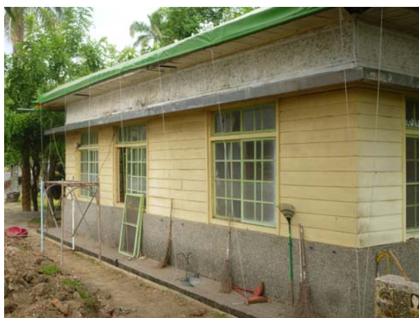
照片4-1-3 木造辦公室背向門窗修復前情形。
