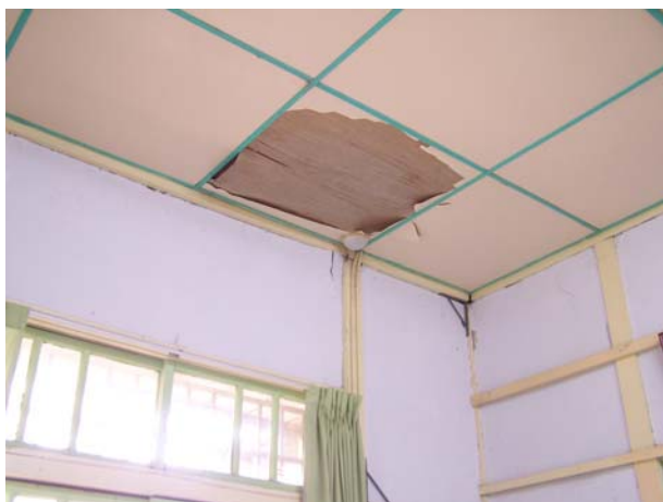
照片4-2-3 儲藏室夾板天花剝落損壞。
