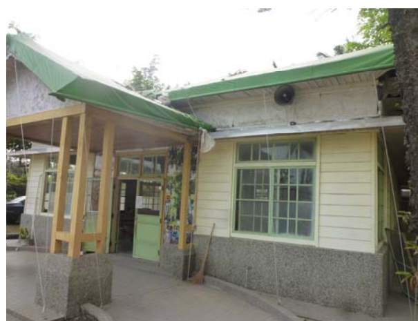
照片4-1-2 木造辦公室正向門窗修復前情形（2）。
