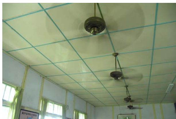
照片4-2-39 辦公室1天花修復前照片(2)。
