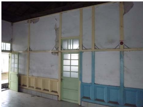
照片4-1-6 木造辦公室室內門扇修復前情形。
