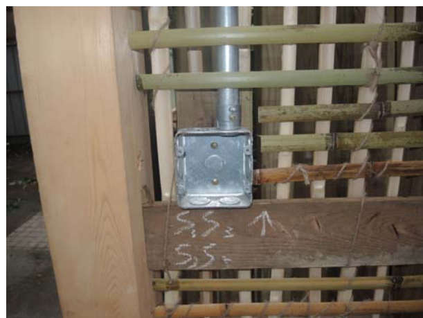
照片4-3-14 電器插座與開關，隱藏施作於牆體內。
