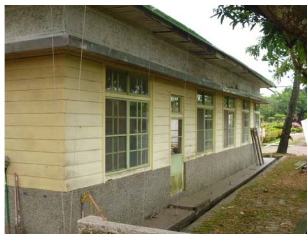
照片4-1-4 木造辦公室右向門窗修復前情形。
