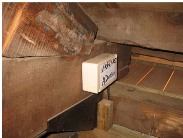
照片4-4-20 地上型餌站設置於屋架上，以屋架兩端為設置，共計 8 處。
