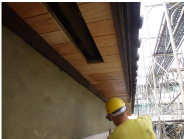
照片4-2-24 主體建築封簷天花舊木料與新木料回鋪後刷塗護木漆。
