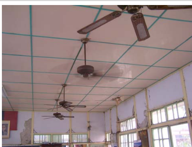
照片4-3-2 木造辦公室 1 修復前室內吊扇設備。
