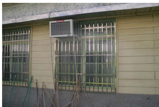
照片4-3-5 後期增設空調窗型冷氣機。
