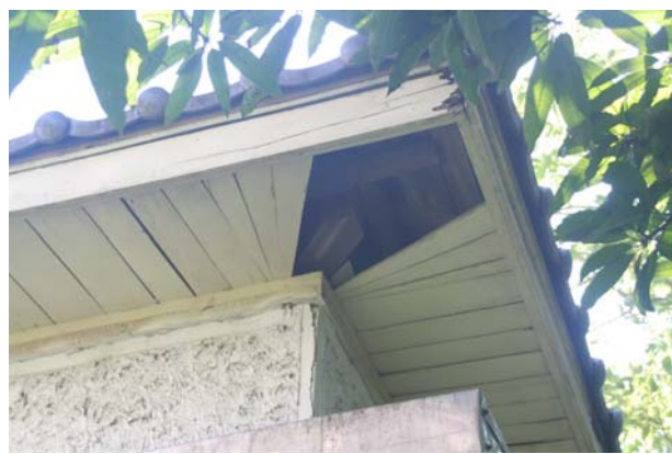
照片4-2-41 封簷天花修復前照片(1)。
