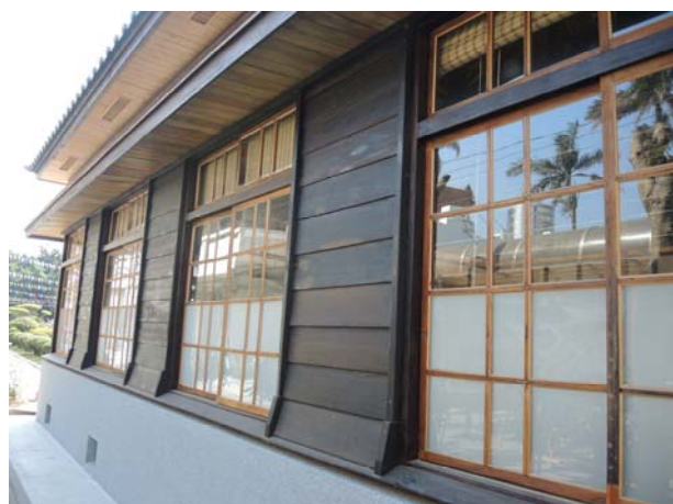
照片4-1-23 窗扇安裝完成後照片，玻璃下層為霧面玻璃，上層為輕玻璃。
