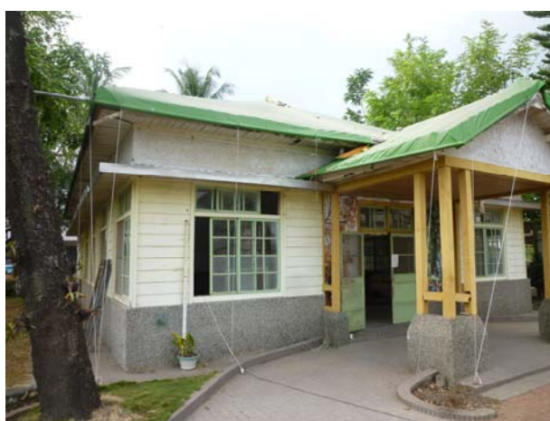
照片4-1-1 木造辦公室正向門窗修復前情形（1）。
