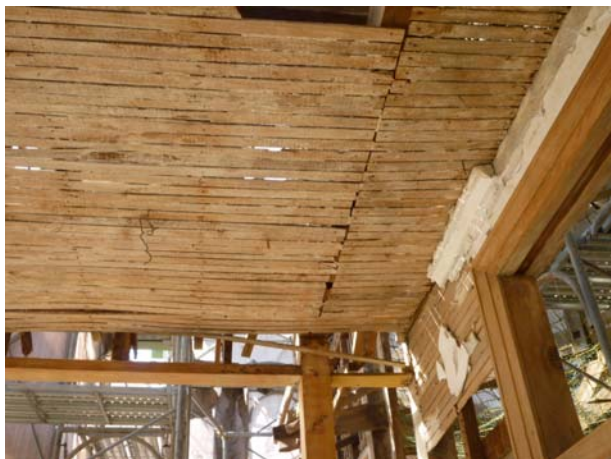
照片4-2-12 車寄木摺天花嚴重損壞。
