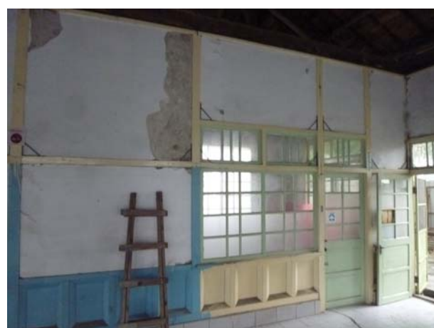
照片3-3-4 軸組與牆體修復前情形 (3)。修復前因地震產生角隅處灰泥牆剝落及軸組傾斜變形，於角隅處施作 L 型角鋼進行補強。
