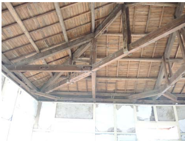
照片3-4-3 木造辦公室屋架修復前情形（3）。
