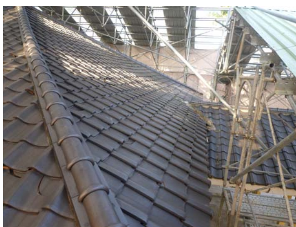
照片3-5-2 屋頂修復前情形 (2)。
