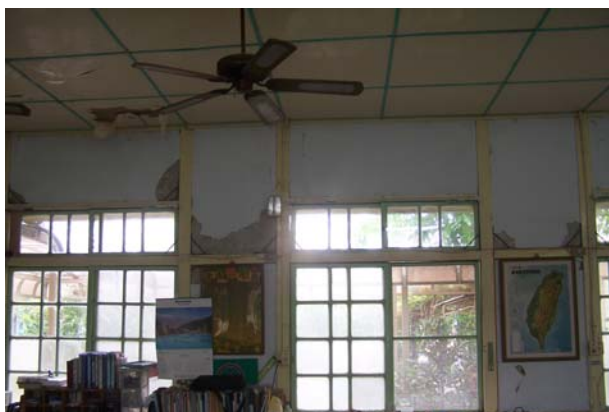
照片3-3-103 辦公室內牆修復前照片(2)。
