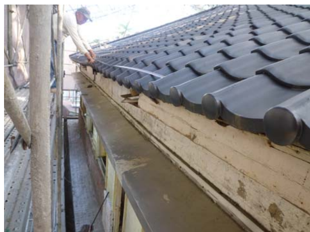
照片3-5-5 屋頂修復前情形 (5)。
