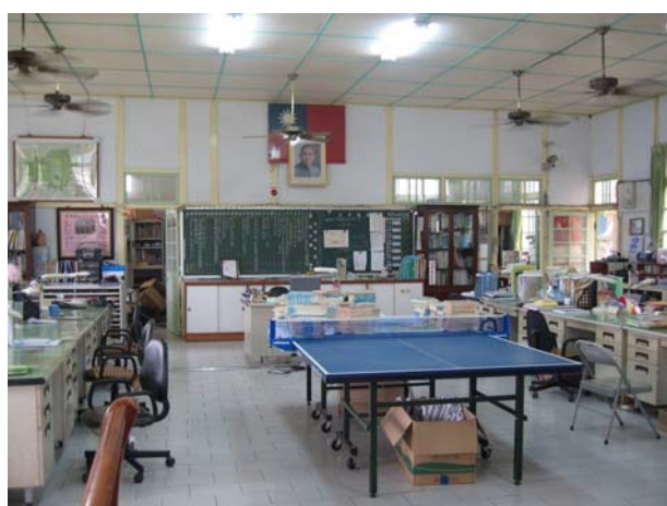
照片3-2-1 辦公室 1 地坪修復前情形。
