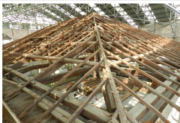
照片3-4-35 屋頂拆卸後可見桁木與桷木損壞情形 (1)。
