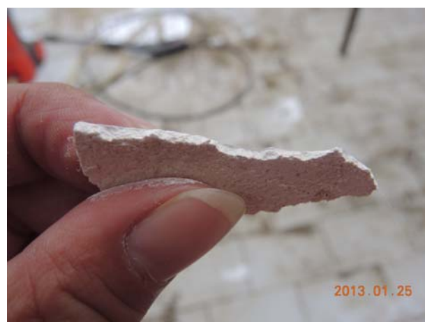
照片3-3-46 原牆體白灰層，白灰層可見些許麻絨。
