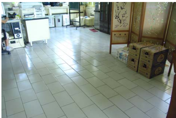
照片3-2-51 室內地坪修復前照片(1)。
