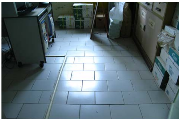
照片3-2-55 室內地坪修復前照片(3)。
