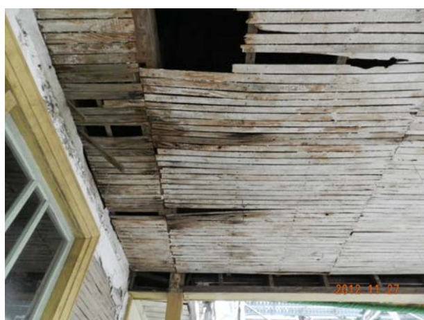
照片3-1-8 車寄入口天花(企口天花板)拆除後發現原貌為木摺灰泥天花。
