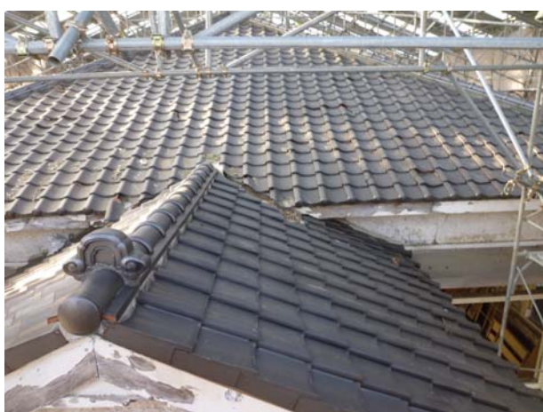
照片3-5-1 屋頂修復前情形 (1)。
