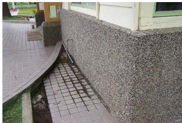
照片3-2-61 東向犬走修復前情形。
