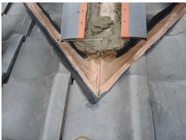
照片3-5-58 車寄正脊瓦施作情形，於左右兩側拉起水線進行鋪設依據。
