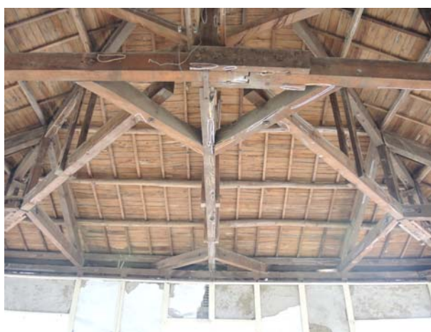
照片3-4-2 木造辦公室屋架修復前情形（2）。
