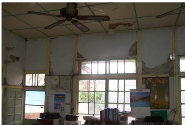
照片3-3-105 辦公室內牆修復前照片(3)。
