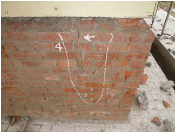
照片3-2-9 面層鑿除，磚牆裂縫待灌注補強環氧樹脂。
