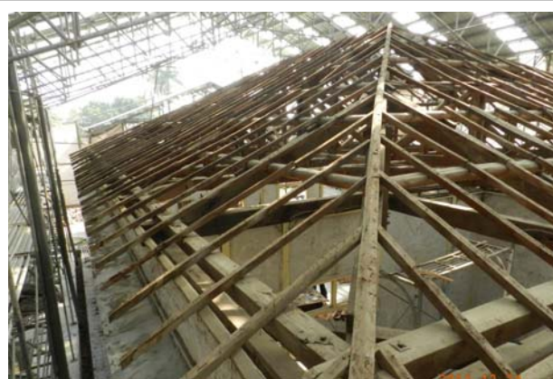
照片3-4-36 屋頂拆卸後可見桁木與桷木損壞情形 (2)。
