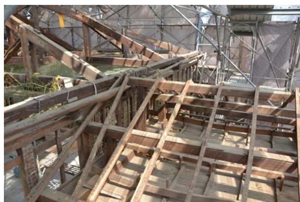
照片3-4-65 屋架修復前照片 (4)。
