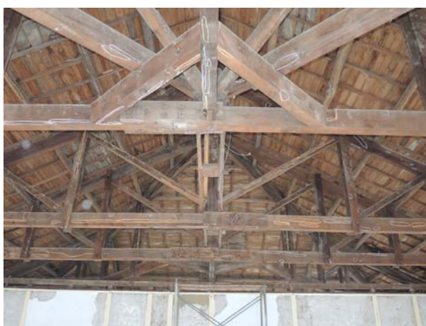
照片3-4-1 木造辦公室屋架修復前情形（1）。
