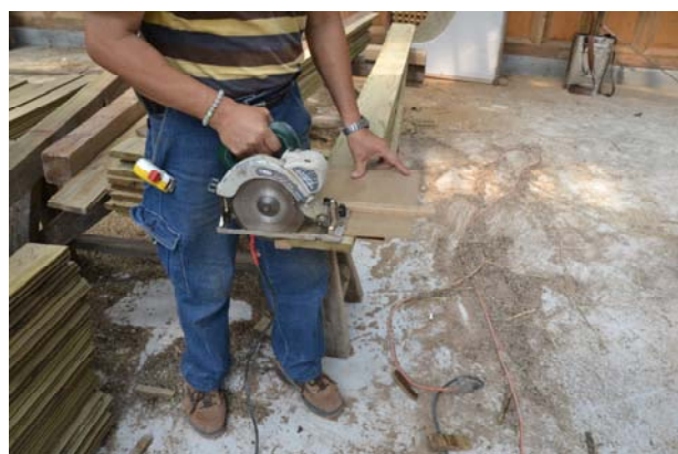
照片3-5-34 裁切適當尺寸再吊運至屋頂上鋪設。詳細尺寸詳右圖所示。
