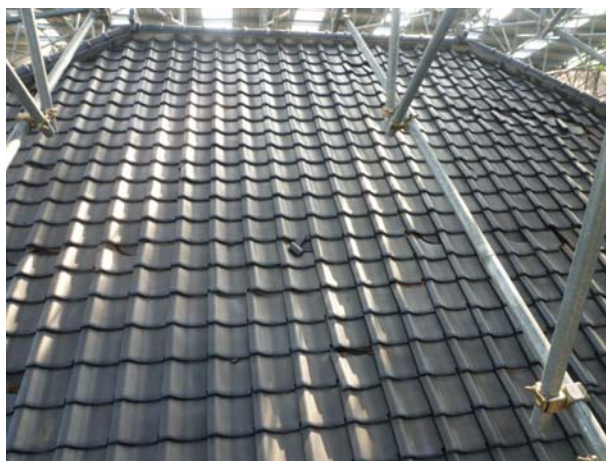
照片3-5-4 屋頂修復前情形 (4)。
