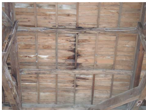
照片3-4-6 修復前屋面板滲水情形。
