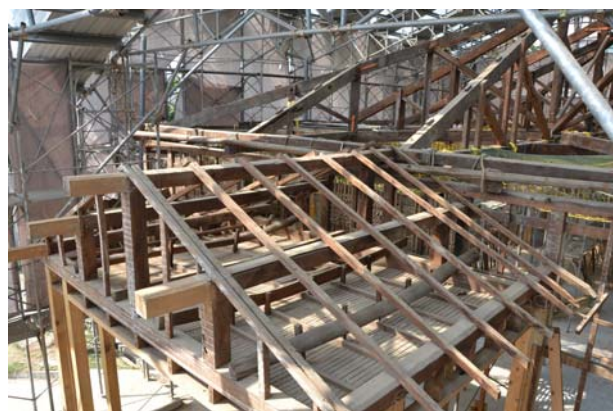
照片3-4-67 屋架修復前照片 (5)。
