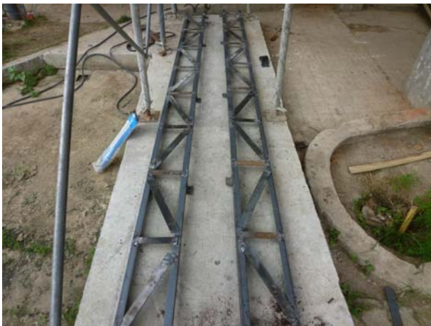
照片3-6-9 人字樑角鋼補強鐵件。
