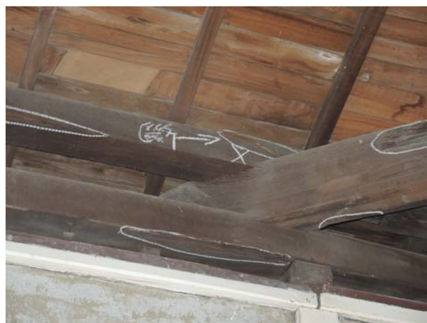
照片3-4-5 修復前屋架軒桁木料劈裂情形。
