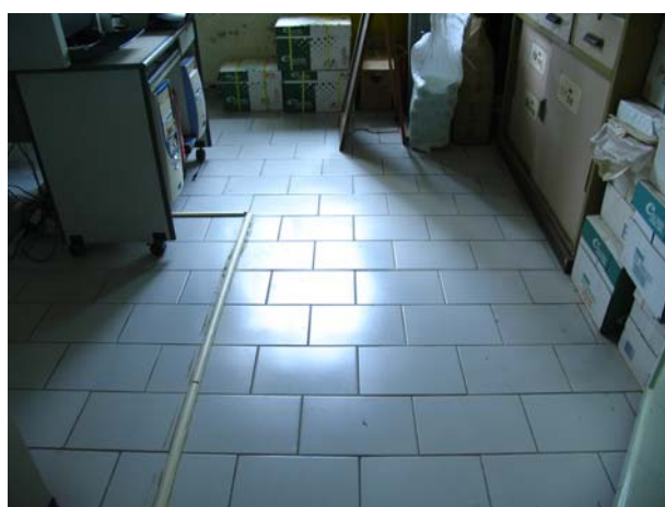
照片3-2-2 辦公室 2 地坪修復前情形。
