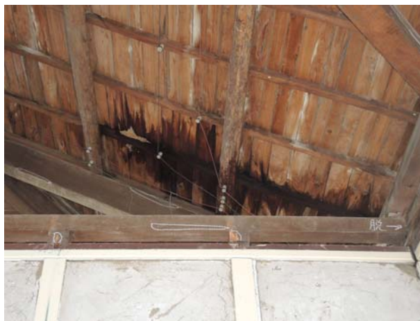
照片3-4-4 修復前屋面板嚴重損壞。
