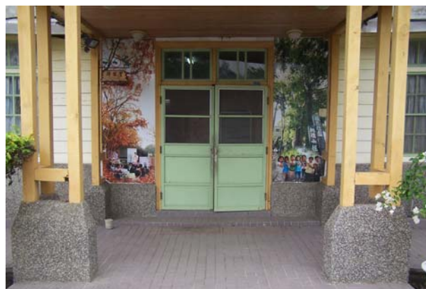
照片3-2-57 車寄地坪修復前情形。
