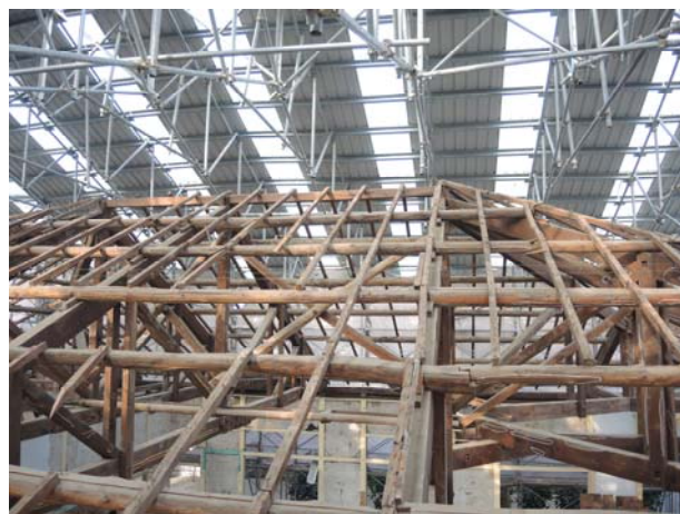
照片3-4-7 屋頂拆除後可見屋架損壞情形。
