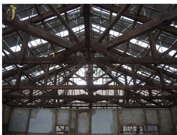
照片3-4-20 屋架損壞處以粉筆進行註記。
