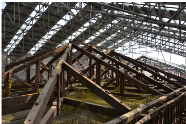
照片3-4-61 屋架修復前照片(2)。
