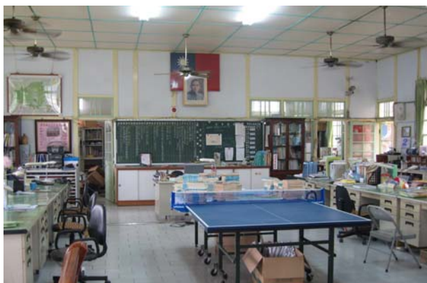
照片3-2-53 室內地坪修復前照片(2)。
