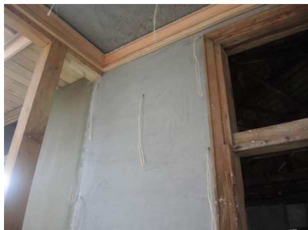
照片3-3-81 外牆木摺灰泥牆於底塗施作後設置麻絨以防止日後龜裂產生。
