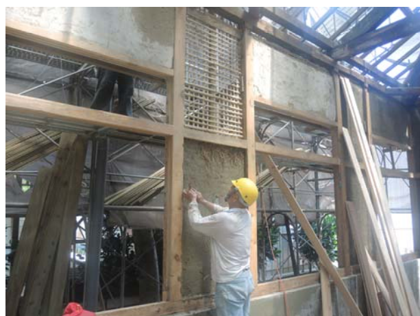
照片3-3-69 在角隅處施作稻草，進行補強以防止角隅處日後龜裂。
