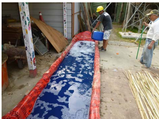
照片3-3-55 竹子殺青藥劑施作。藥劑為木材 ACQ 防腐使用之銅烷基安化合物。
