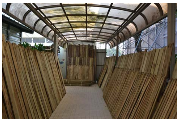
照片3-5-32 屋面板經過 ACQ 防腐處理後，運至工地現場陰乾後待進行鋪設施作。
