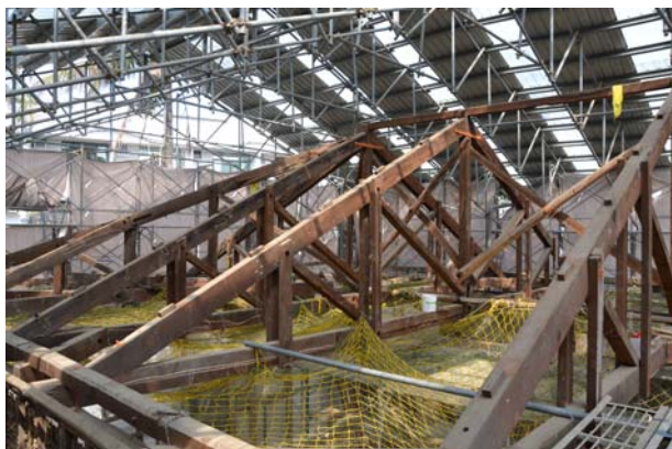
照片3-4-59 屋架修復前照片(1)。
