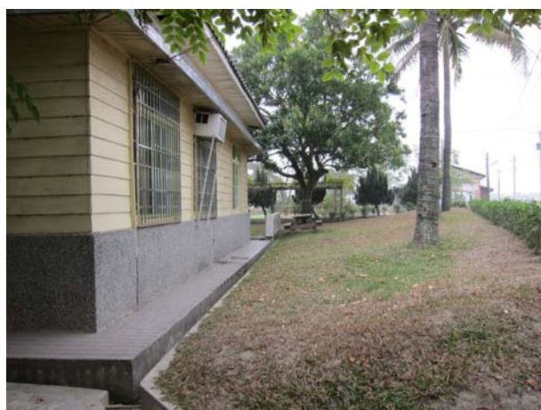
照片3-2-4 辦公室西向基牆與犬走地坪修復前情形。
