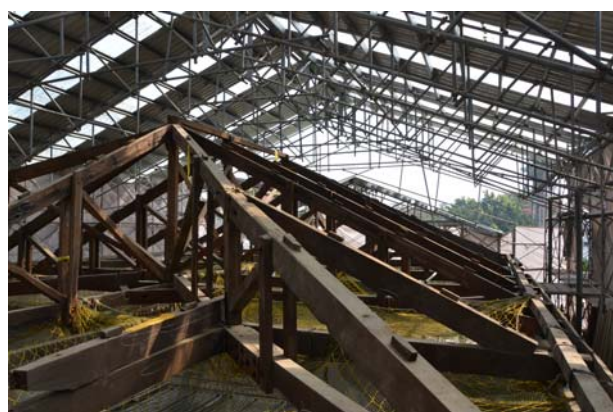
照片3-4-63 屋架修復前照片 (3)。
