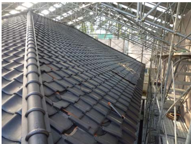
照片3-5-3 屋頂修復前情形 (3)。
