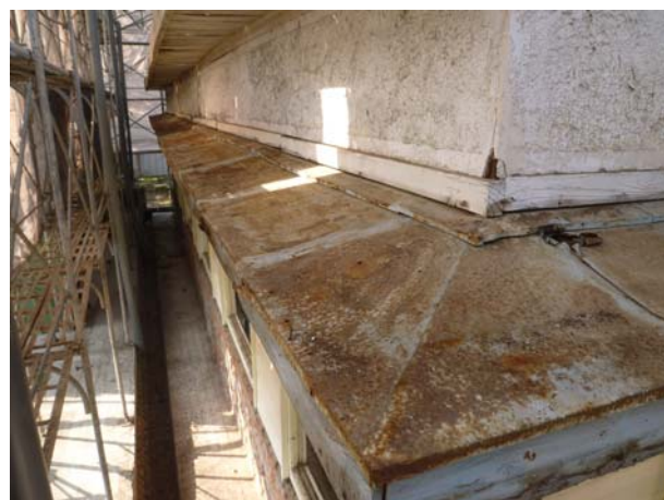
照片3-5-6 出簷屋頂修復前情形。
