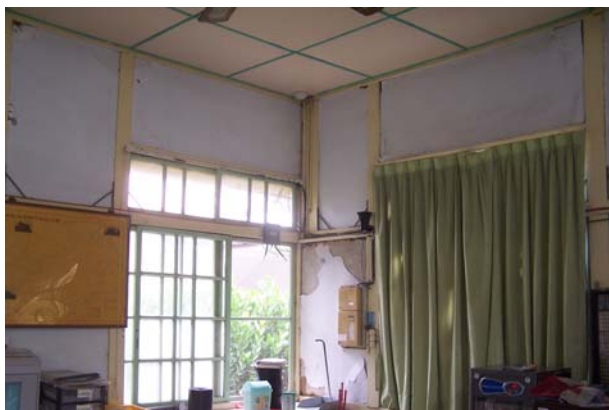
照片3-3-101 辦公室內牆修復前照片(1)。
