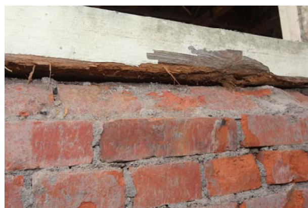
照片3-3-10 基牆面層粉刷層剝除後，可見軸組損壞情形（詳上圖位置）。
