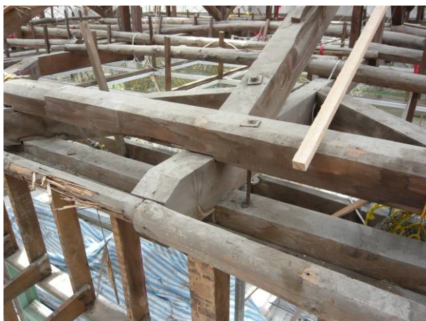
照片5-4-7 安溪國小辦公廳舍屋面拆除後，發現陸樑末端釘著 D-φ 12cm 簷桁。(照片來源：安溪國小辦公廳舍搶修工程工作報告書 P3-115 照片 3-6-45)
