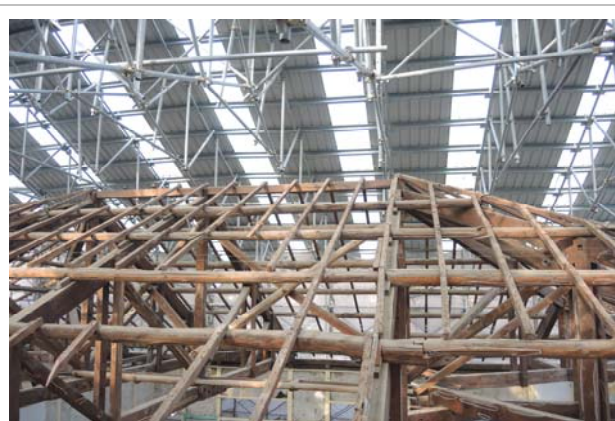
照片5-1-2 屋架修復前損壞情形。
