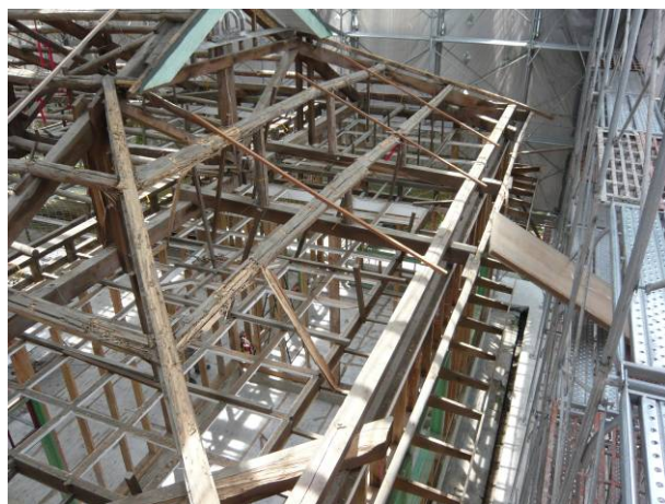
照片5-4-8 安溪國小辦公廳舍西向屋架桁木修復前情形。(照片來源：安溪國小辦公廳舍搶修工程工作報告書 P3-115 照片 3-6-44)
