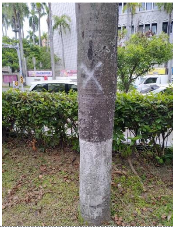
地點：警衛室前方第3棵大王椰子 狀況：單點腐朽、有潛在危險 處置方式：移除
