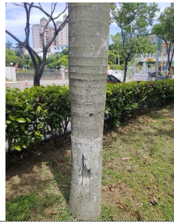
地點：警衛室前方第5棵大王椰子 狀況：樹幹中空腐朽、有潛在危險 處置方式：移除
