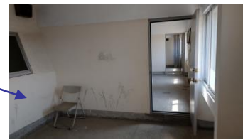
綜合大樓四樓燈光控制室
