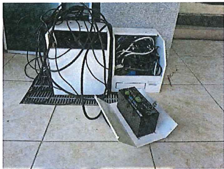
2 個資訊整合控制設備
