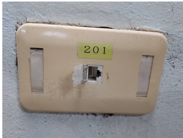
舊網路孔, 每班1~4個不等 走暗管, 貼在牆壁上
