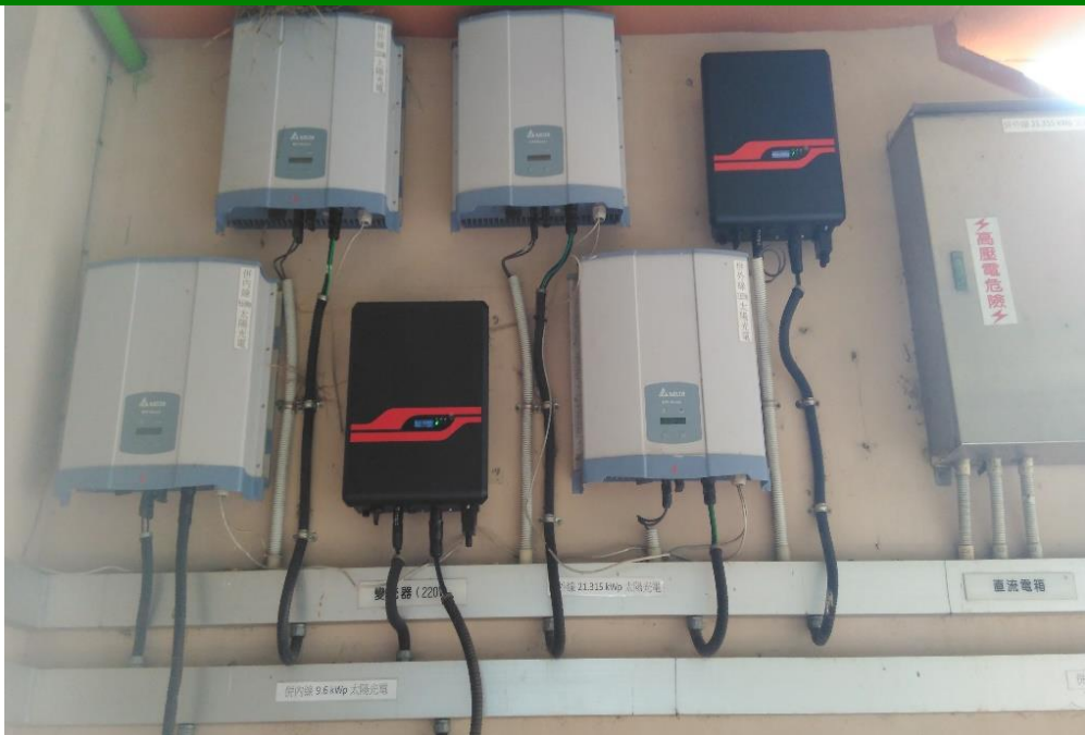
本校自行設置的太陽能發電逆變器
