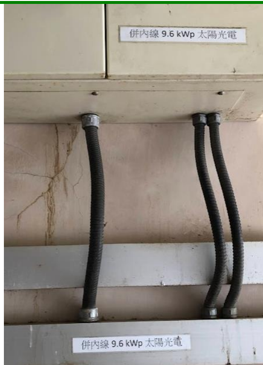
自有太陽能光電系統 9.6kWp 供校內自用
