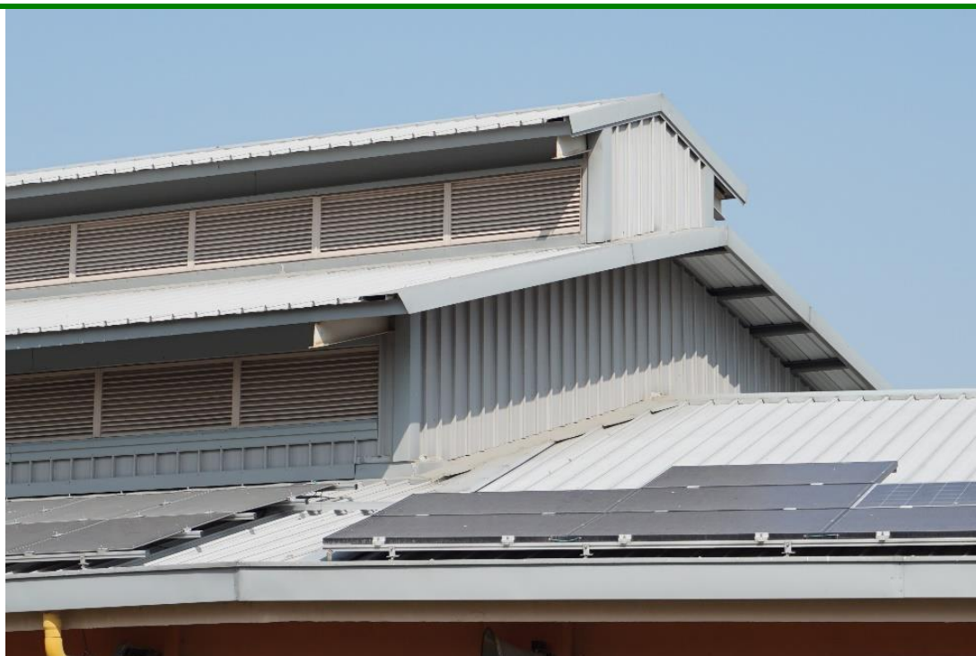
本校惠育樓屋頂南面設置太陽能板(自有及場地租賃)
