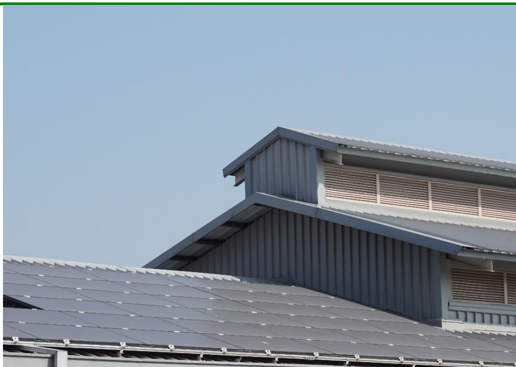
本校惠育樓屋頂南面設置太陽能板(自有及場地租賃)
