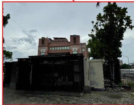
高壓電站有安全風險，請勿接近
