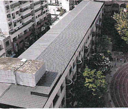
▲ 西棟與美術大樓屋頂搭建了鋼構浪板，解決老舊校舍頂樓漏水悶熱的問題。
